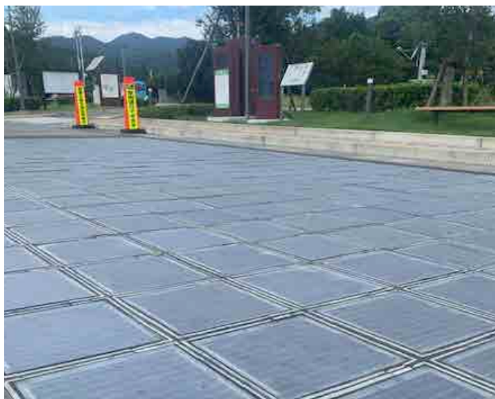
町役場の駐車場に設置された路面太陽光パネル
