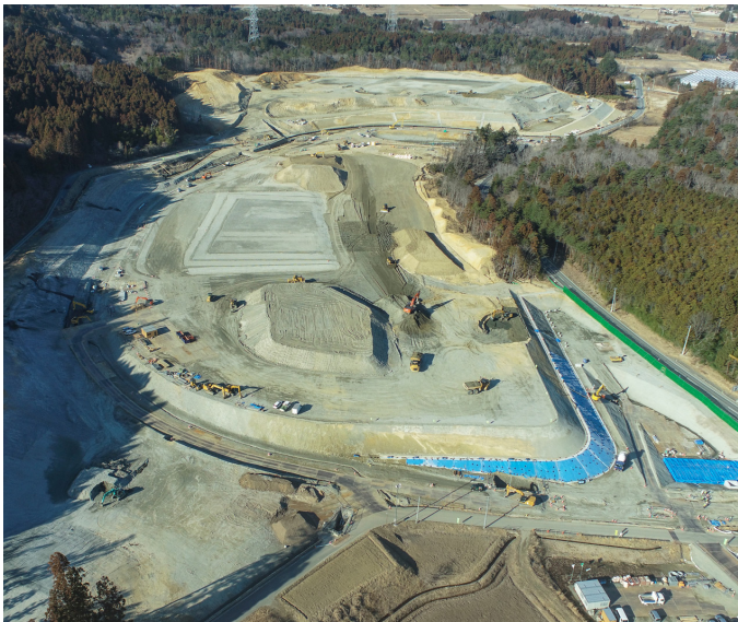
造成が進む大熊西工業団地
