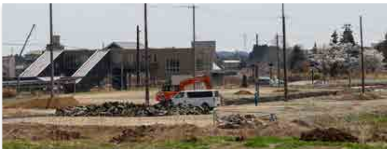
大野駅西で進む造成工事。右奥に西口の桜。ホーム側の桜は伐採されました
