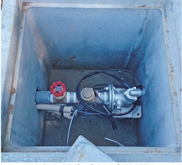
完成した水中ポンプ (イチゴ工場整備)
