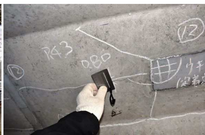
頂版ハンチ部のひびわれ
