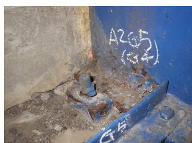
主桁端部の腐食
