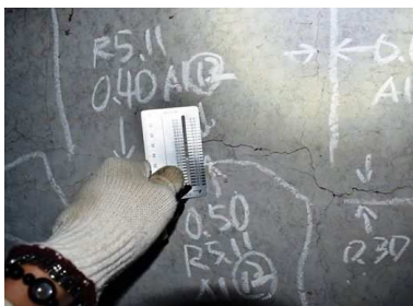
頂版ハンチ部のひびわれ
