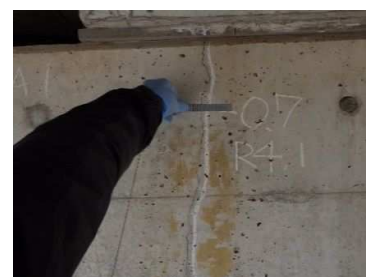
下部工のひびわれ・遊離石灰
