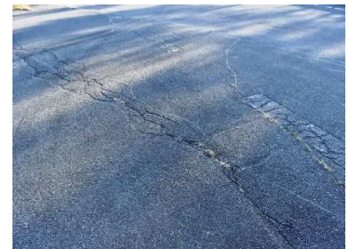
舗装路面のひびわれ、段差
