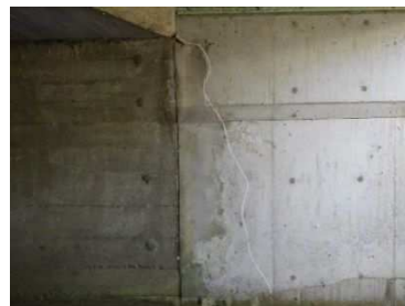
下部工のひびわれ
