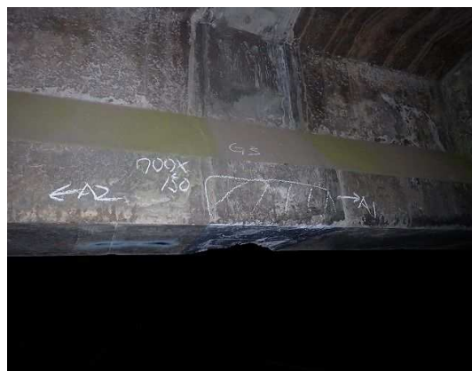
ポステン桁接合部下面のうき
