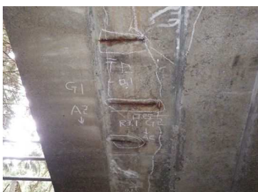
主桁の鉄筋露出
