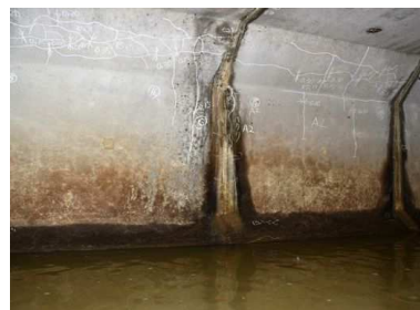
側壁のひびわれ、目地部の遊離石
