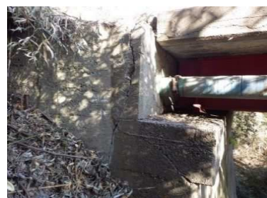
下部工のひびわれ・うき、欠損
