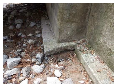
下部工の欠損、洗堀
