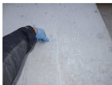
横桁定着部のひびわれ、遊離石灰
