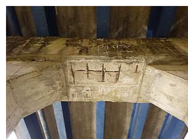
下部工の鉄筋露出
