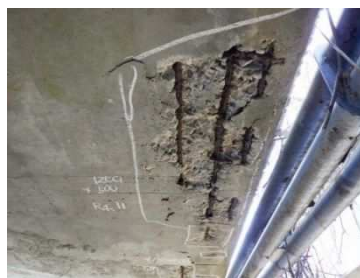
床版の鉄筋露出
