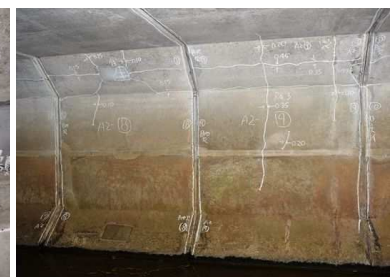
側壁のひびわれ、遊離石灰
