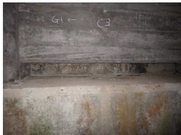
下部工の遊離石灰
