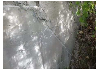
下部工のひびわれ
