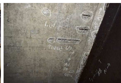
床版の鉄筋露出
