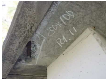
主桁定着金具の露出
