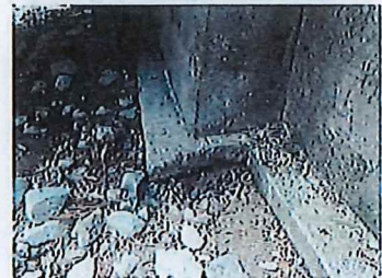
下部工の欠損、洗堀(Ⅱ)
