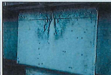
横桁定着部のひびわれ、遊離石灰(Ⅱ)
