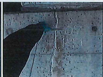
下部工のひびわれ・遊離石灰(Ⅱ)
