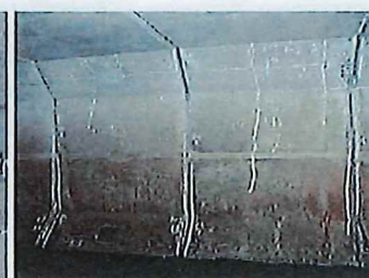
側壁のひびわれ(II)
