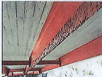
主桁の腐食(Ⅱ)
