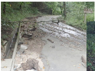
▲洗掘され大きくえぐれた林道
